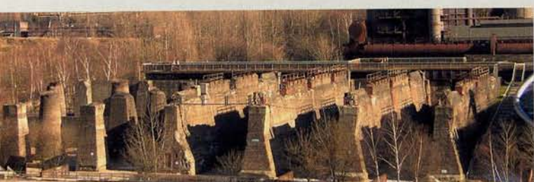
Abb. 13: Ein Duisburger »Beton-Landschaftsbild« – viele Schadenstypenbilder
