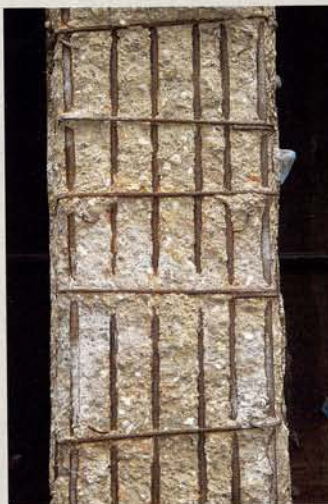
Abb. 5: Originaloberfläche wurde durch Korrosionsdruck der Stähle flächig in Schalenform abgedrückt.
