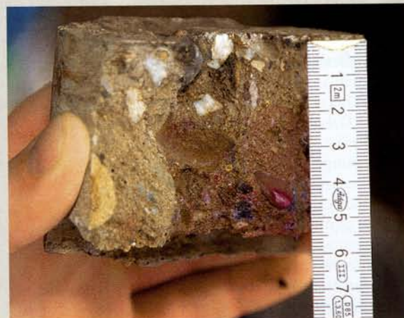
Abb. 9: Gefährdete Bewehrung, wie die Carbonatisierungstiefe zeigt
