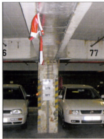
Abb. 4: Typisches Feuchteschadensbild in der Tiefgarage, hier an einem Stützpfeiler
