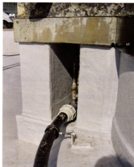
Abb. 3 + 4: Die Abdichtung musste nicht nur wasserdicht, sondern auch beständig gegen Chlorbleichlauge sein.
