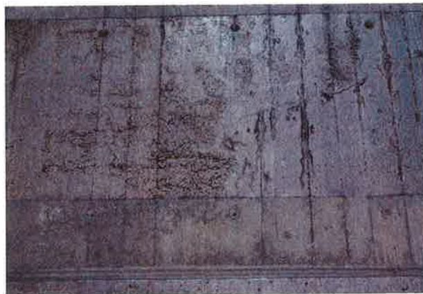
Bild 2 Der Begriff ‚Betoninstandsetzung‘ bezieht sich im Allgemeinen auf die Schadensbeseitigung bei Bestandsbauten. Beim Neubau wird die Mängelfreiheit beinahe als selbstverständlich vorausgesetzt. Doch die Realität ist anders, wie das Bild zeigt. Von außen sichtbare Kiesnester beeinträchtigen die Dauerhaftigkeit sowie den Lastabtrag und unter Umständen auch den Brandschutz.
