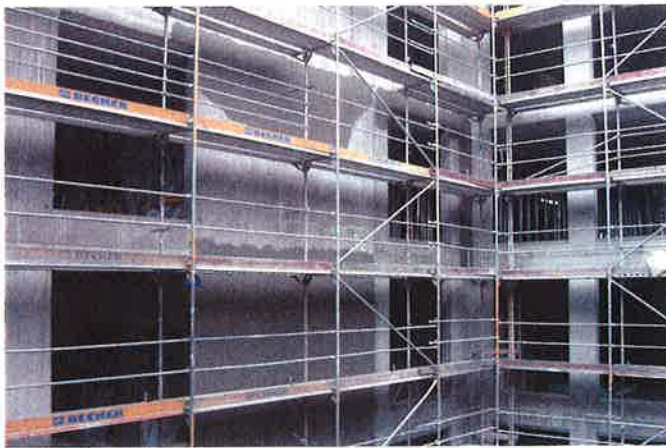
Bild 4 Fassade mit bereichsweise überschrittenen Rohbautoleranzen.
