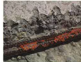
Der Bodenkonus des Düsseldorfer Rheinturms wies ringförmige Betonausbrüche und Bewehrungskorrosion auf. Die exponierte Lage des Turms und seine Bedeutung als Touristenattraktion verlangten eine sichere und dauerhafte Instandsetzung.
