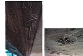
Markierung von Schadstellen. Bildnachweis (4): Rita Jacobs
