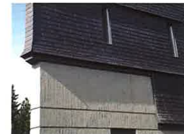
Durch das Eindrücken einer Brett-schablone in die noch frische, planeben abgezogene Oberfläche wurde die alte Struktur des schalungsrauen Betons rekonstruiert. Fotos(3): Rita Jacobs
