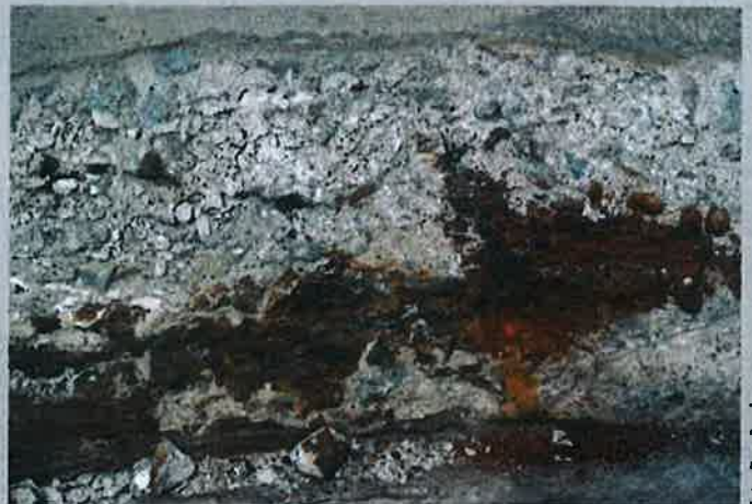
Typischer Schaden an Brücken: Abgeplatzter Beton an den Randeckungen mit darunter liegenden Korrosionsschäden der Bewehrung.
