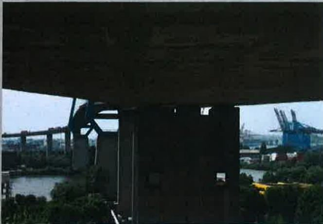
Wie ein Flickenteppich sieht die Köhlbrandbrücke von unten aus, wenn die Instandsetzungsarbeiten abgeschlossen sind.
