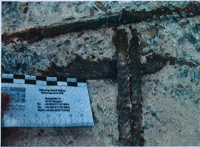
Schadstellen, Ausbruchtiefe, korrodierte Bewehrung
